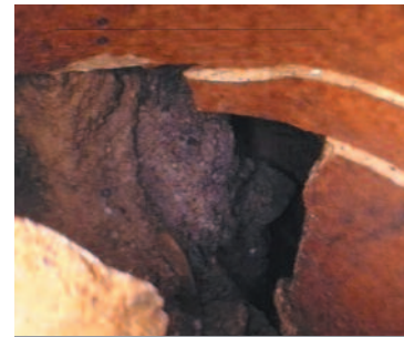
Fehlendes Rohrstück, Hohlraum sichtbar
