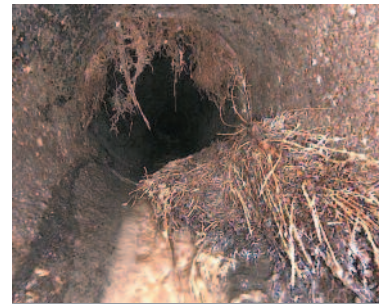
Wurzeleinwuchs an undichter Rohrverbindung
